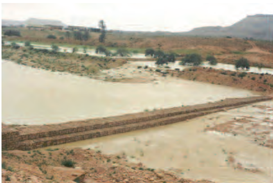
Ouvrages de recharges des nappes en Tunisie
