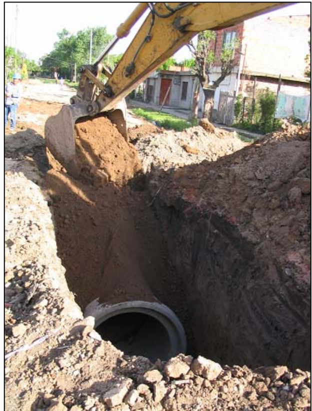
Enfouissement d'un réseau d'égout dans un quartier régularisé du programme PROMEBA à Buenos Aires (Argentine).
