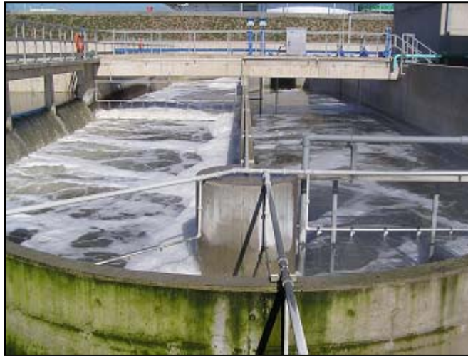
Usine de traitement des eaux usées de la Farfana à Santiago de Chile (Chili).
