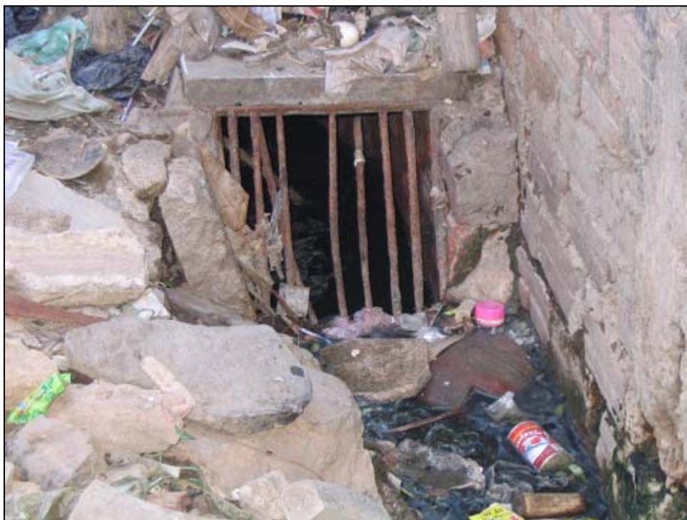
Drain bouché par des ordures ménagères dans un bidonville de Phnom Penh (Cambodge).
