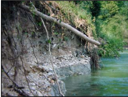
Photo 8 : berges d'érosion sur un site incisé de la basse vallée de l'Ain.
