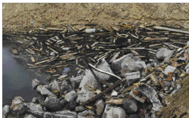
Les remblais et digues devraient toujours être construits avec des matériaux d'excellente qualité, présentant une bonne cohésion, et dénués de risque de pollution.
