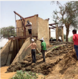
Mise en place de la station à Kollo
