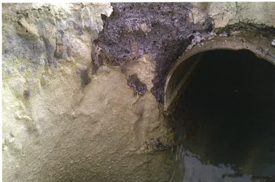
Sur les réseaux d'assainissement, on peut souvent constater des effritements des bétons, des traces de coulures sur les parois, des échelons corrodés dans les regards, des intérieurs de tampon anormalement corrodés...
