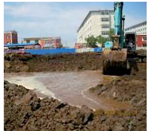
Pertes provoquées par un chantier mal organisé
