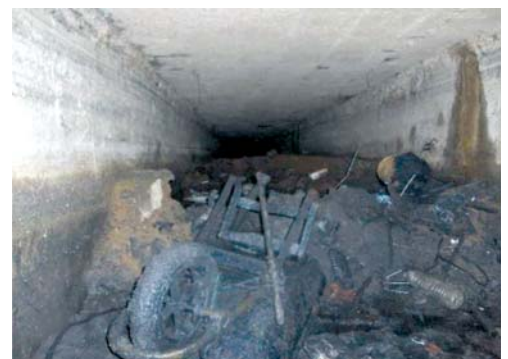
Divers déchets dans un collecteur d'eaux usées avant le nettoyage
