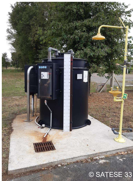
Figure 20 : Stockage du chlorure ferrique en cuve
