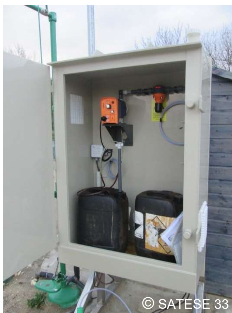
Figure 21 : Stockage du chlorure ferrique en bidons de 25 litres
